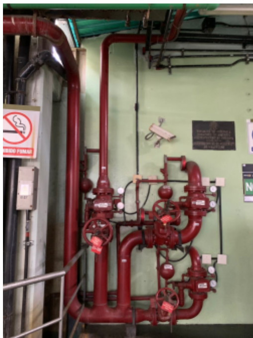
Instalaciones contra incendios.jpg
