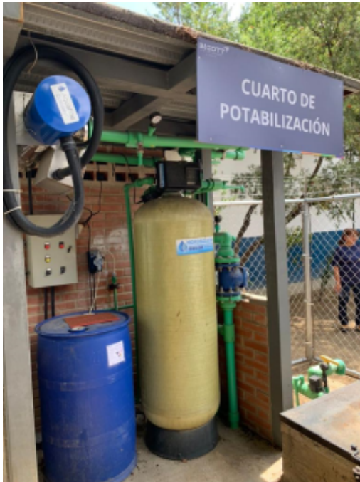
Zona de filtros.jpg
