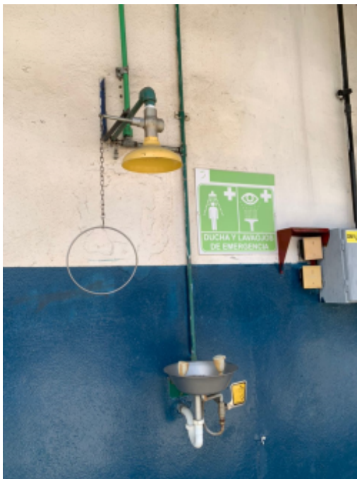
Instalaciones para lavado de emergencia.jpg
