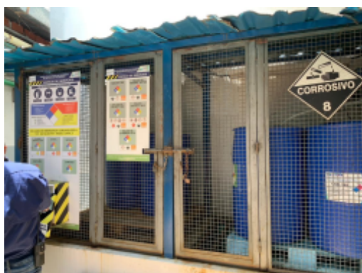
Almacen de productos corrosivos.jpg
