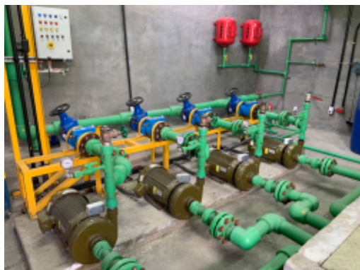
sistema de bombas y tuberias.jpg
