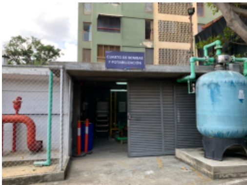
Cuarto de bombas.jpg
