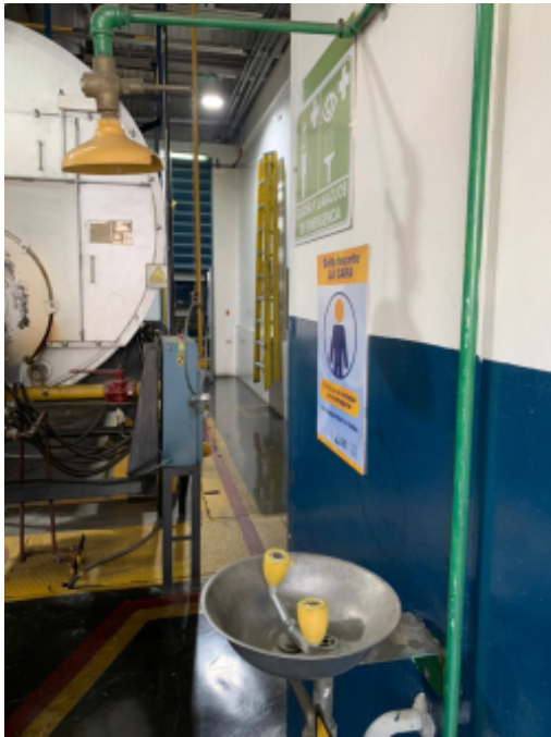
Área de Calderas.jpg
