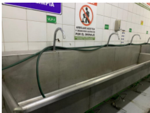
Zona de lavado con pedales.jpg
